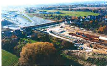
D3 0310/1 poslední podzimní práce před zprovozněním – železobetonový tunel mizí pod zásypy zeminou (podzim 24, ŘSD)
